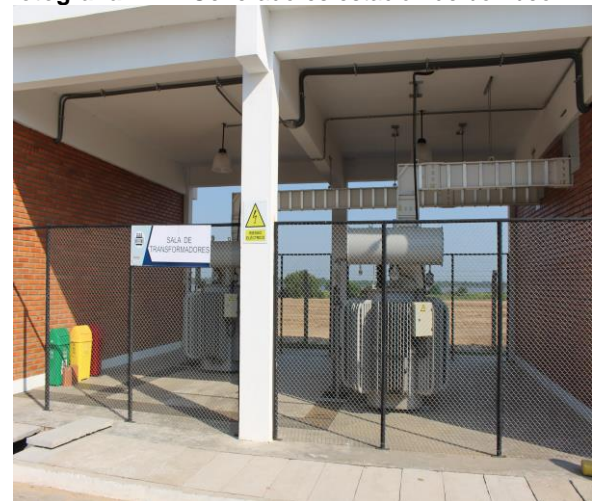
Fotografía N° 4: Sala de Transformadores
