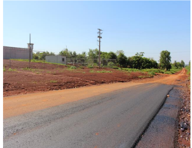
Fotografía N° 2: Capa asfáltica finaliza frente a la Penitenciaría de Minga Guazú
