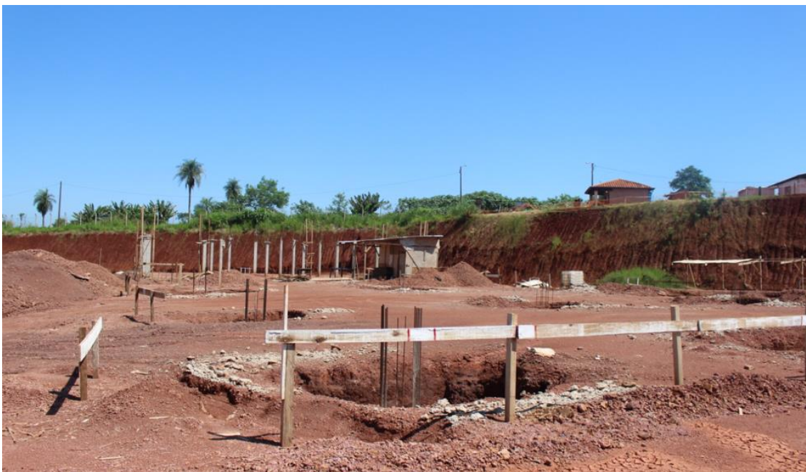
Fotografía N° 3: Etapa de fundaciones, durante la visita no se ha visualizado personales de la contratista trabajando.
