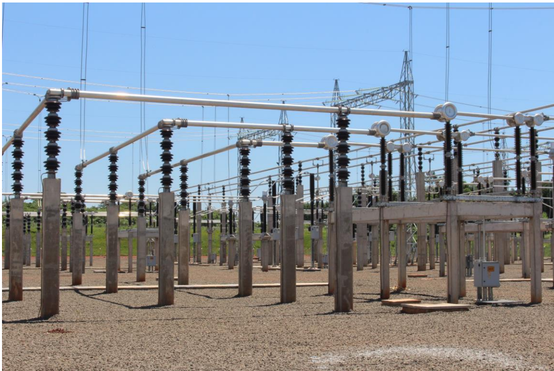
Fotografía N° 2: Vista lateral de patio de Subestación
