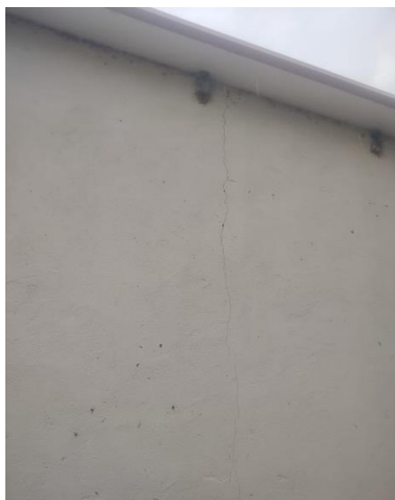
Fotografía N° 5: Fisuras en paredes de viviendas
