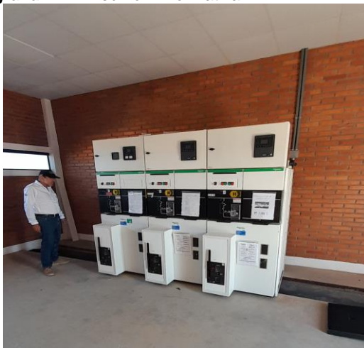
Fotografía N° 3: Sala de Celdas de control de Media Tensión
