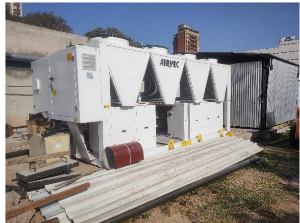
Fotografía N° 18: Registro de Refrigeración ubicado a las afueras del edificio del palacio.
