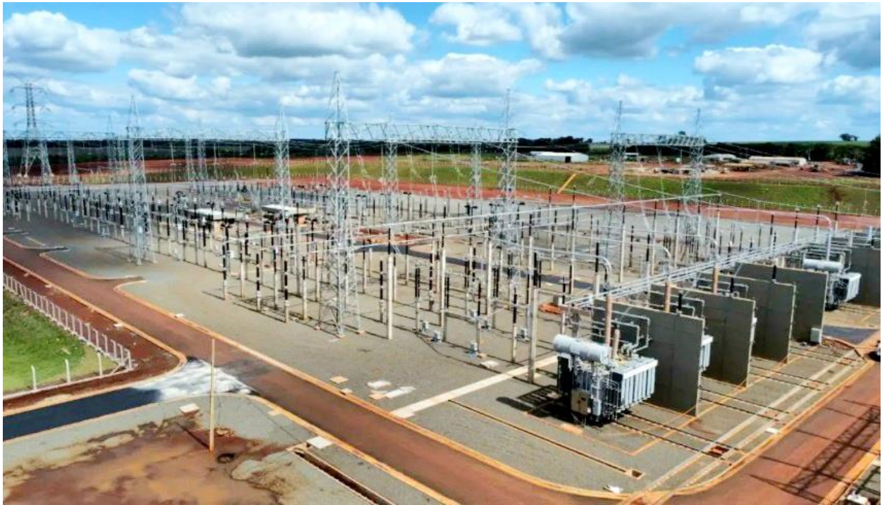
Fotografía N° 1: Vista panorámica de Subestación
