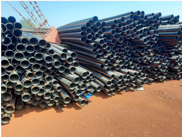
Fotografía N° 9: Tubos para aislación de cables subterráneos
