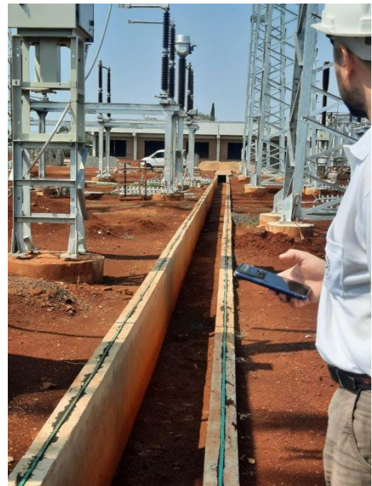
Fotografía N° 6: Canaletas para instalación de cableado
