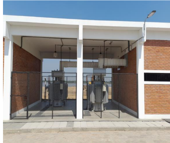
Fotografía N° 16: Sala de Transformadores estación de bombeo Ñeembucú
