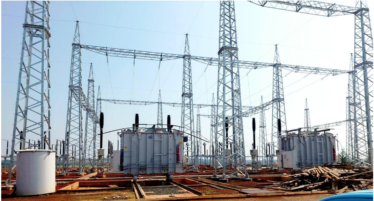
Fotografía N° 4: Banco de Transformadores
