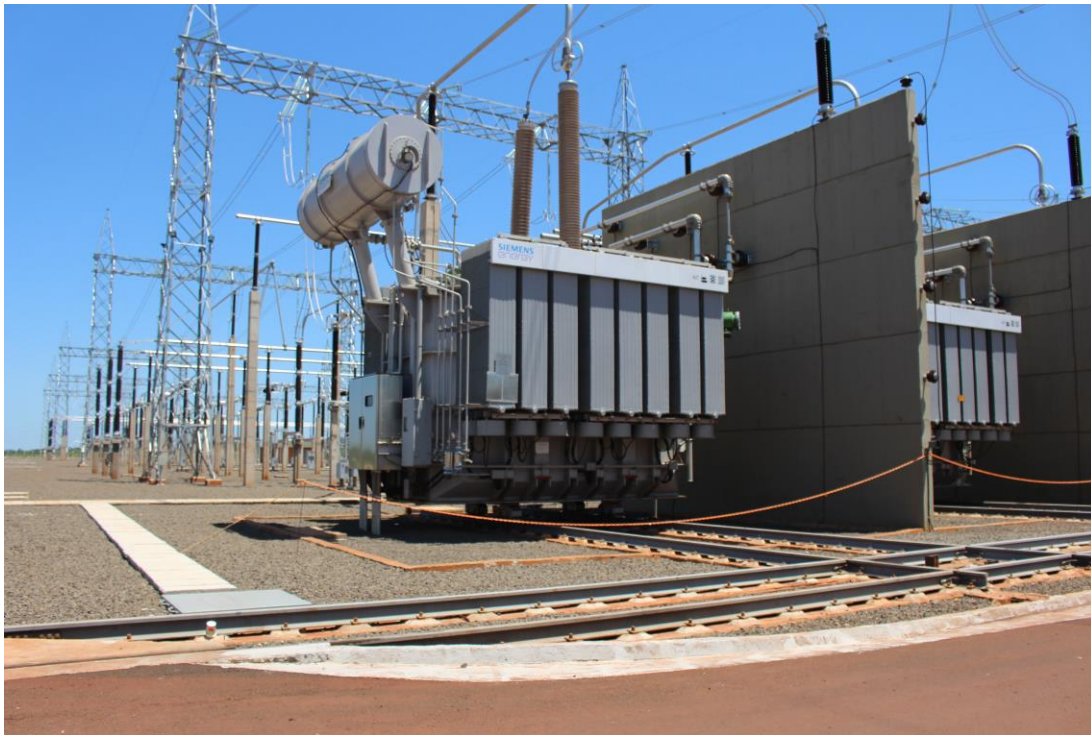
Fotografía N° 6: Transformadores de potencia
