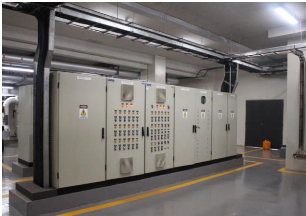
Fotografía N° 5: paneles de control eléctrico del complejo
