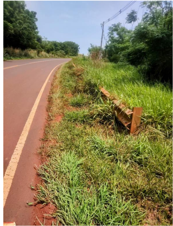
Fotografía N° 5: Baranda de protección cubierta por malezas.
