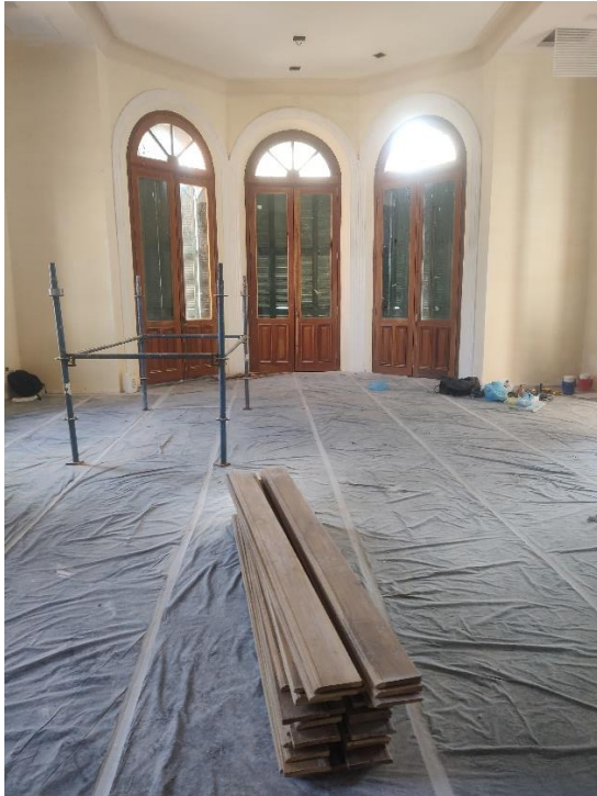
Fotografía N° 10: Paredes del salon principal de la planta baja completamente restaurados y los pisos de parquet en proceso de pulido.
