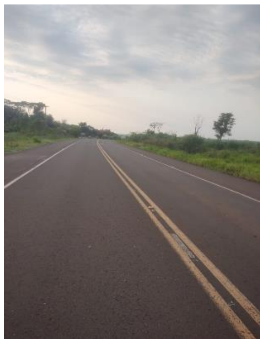
Fotografía N° 2: Estado de la ruta con banquetas, se observa en excelente estado en Curuguaty.
