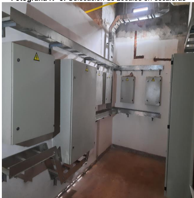
Fotografía N° 7: Tableros eléctricos instalados
