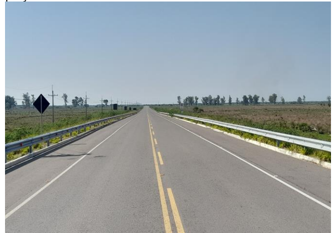
Fotografía Nº 16: Vista del estado de la carpeta asfáltica obra 2.
