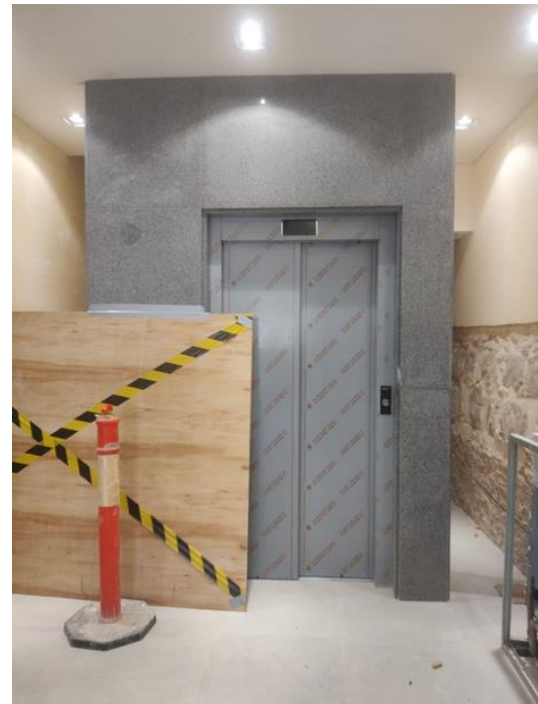
Fotografía N° 3: Ascensor ubicado en el subsuelo.
