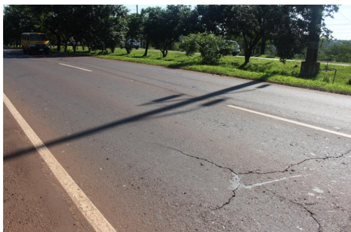
Fotografía N° 3: Fisura que necesita intervención, camino a Hernandarias
