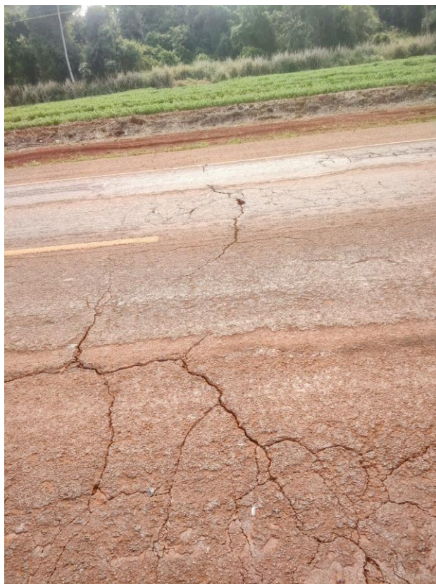
Fotografía N° 9: Fisuras (piel de cocodrilo)
