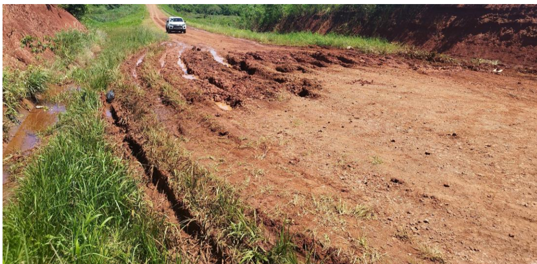
Fotografía N° 4: La corriente de agua fluye por el camino a causa del taponamiento de la cuneta
