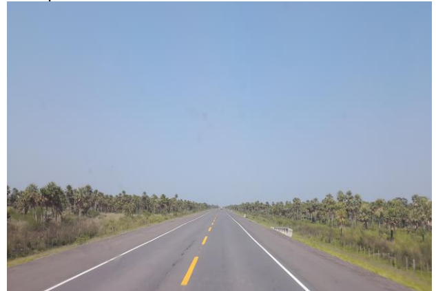
Fotografía N° 4: Vista del estado de la carpeta asfáltica de la Obra 1.
