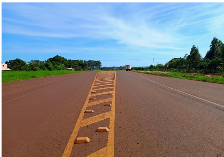
Fotografía N° 7: Fin del Tramo 1 monitoreado, antes de llegar a la primera Rotonda de Carlos Antonio López
