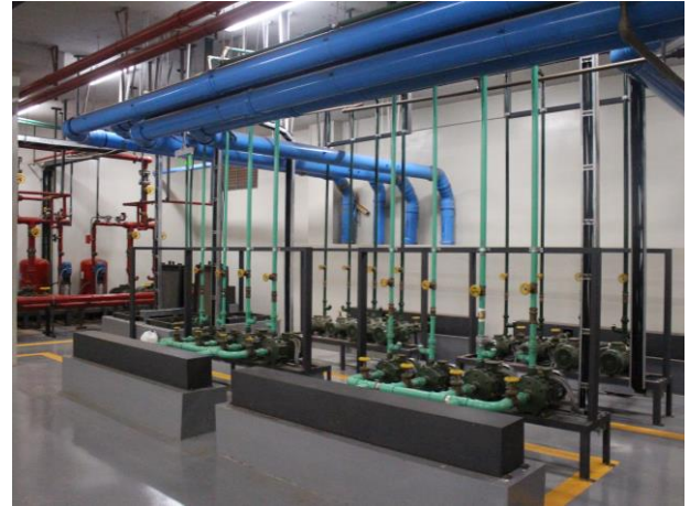
Fotografía N° 4: sistema de tratamiento y distribución de agua.
