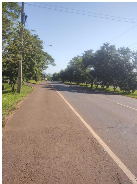
Fotografía N° 2: Pinturas y banquetas bien cuidadas, sin embargo, se visualiza leves fisuras en tramos menos transitados en Hernandarias.
