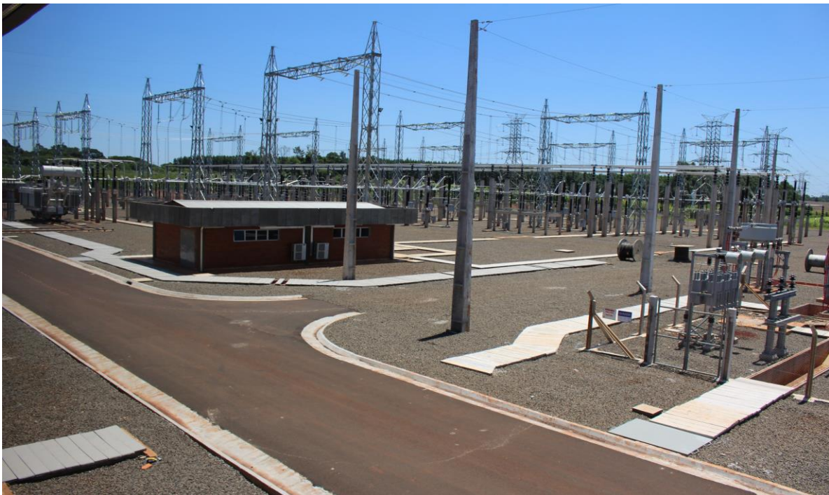
Fotografía N° 4: Patio de torres y caseta de relés
