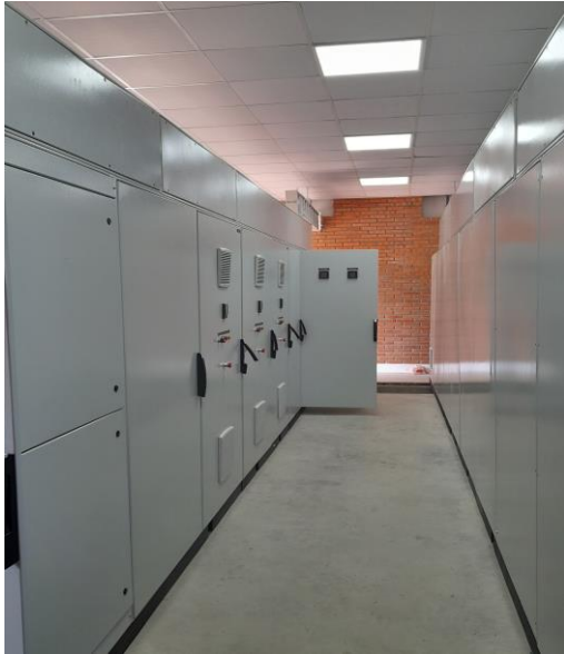
Fotografía N° 5: Sala de Tableros
