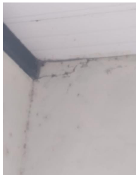
Fotografía N° 6: Fisura profunda en paredes
