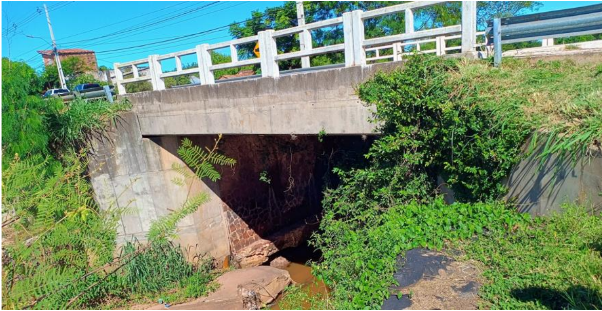
Fotografía N° 6: Debajo del mismo puente se observa el crecimiento de malezas y la base socavada.
