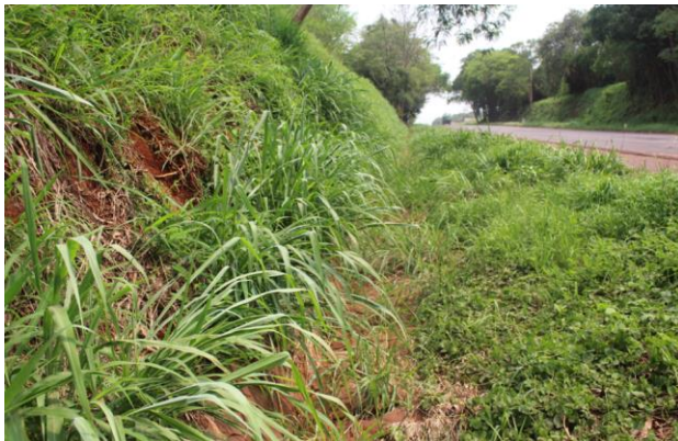
Fotografía N° 6: cunetas revestidas por malezas
