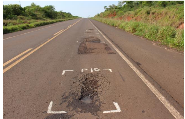
Fotografía N° 6: La mayoría de baches identificados se encuentran juntos.
