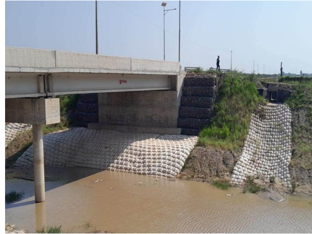
Fotografía N° 10: Sistema de protección de talud en puente sobre canal de derivación San Lorenzo
