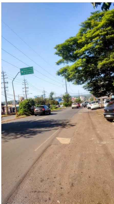
Fotografía N° 1: Estado de la ruta al Inicio del recorrido en Ciudad del Este, ahucamiento de las banquetas en zonas de alto tránsito.
