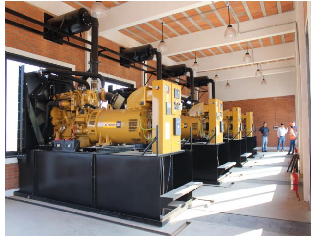
Fotografía N° 2: Generadores estación de bombeo
