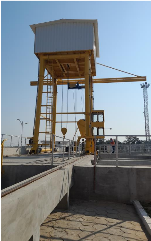
Fotografía N° 7: Grúa para operar compuertas
