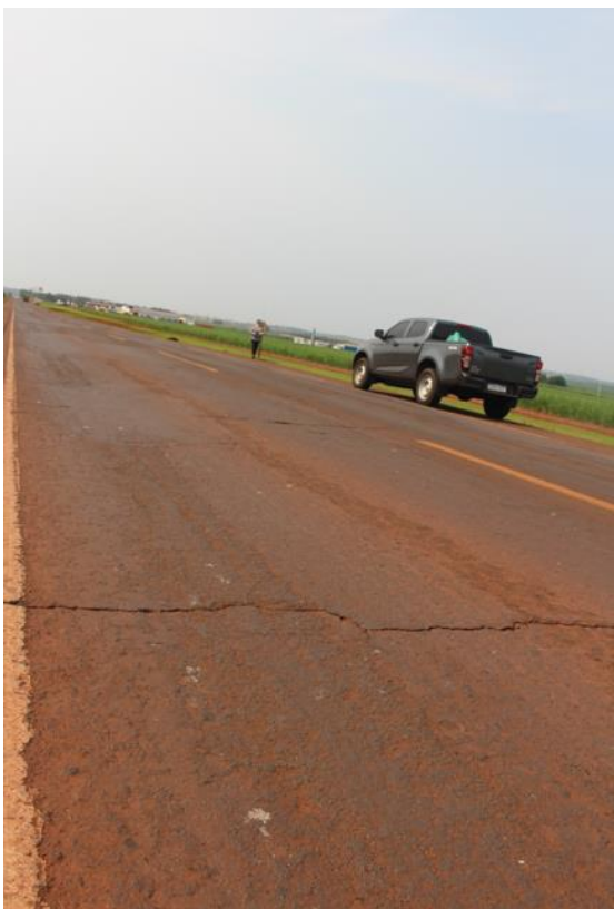
Fotografía N° 8: Fisuras (piel de cocodrilo) en varios tramos
