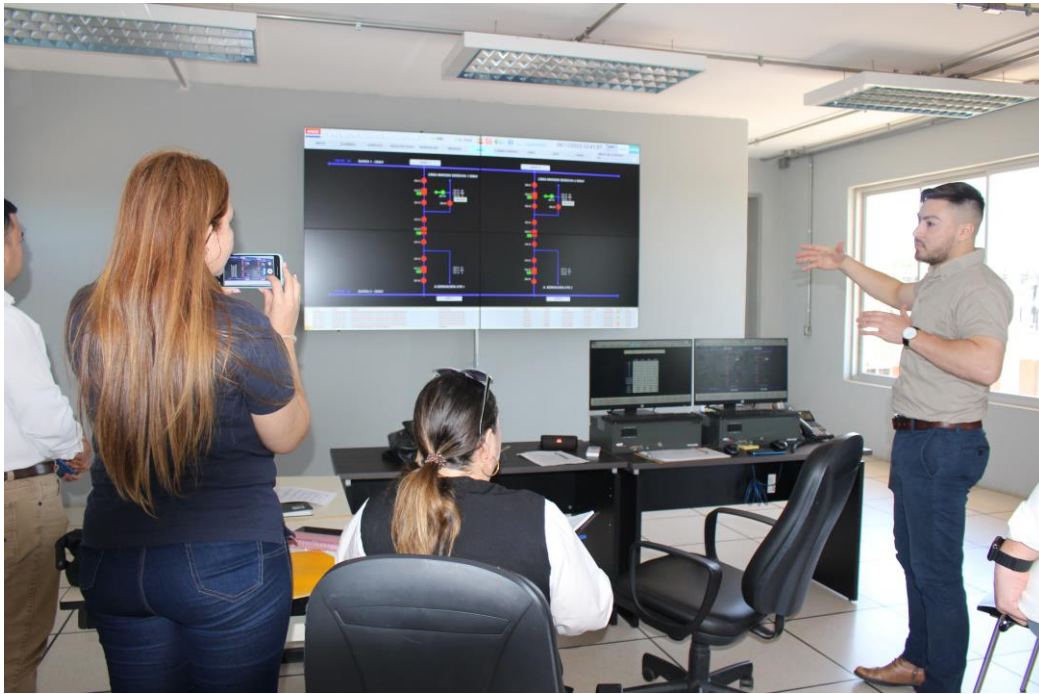
Fotografía N° 5: Sistemas de monitoreo en sala de control
